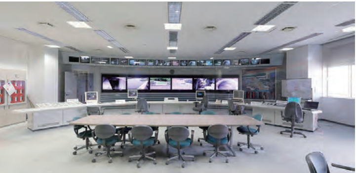
操控流入設施、排水泵設備、排水暗渠並集中監控整座設施的中央操作室
