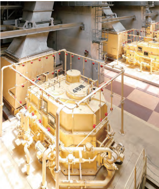
排水泵室全景
