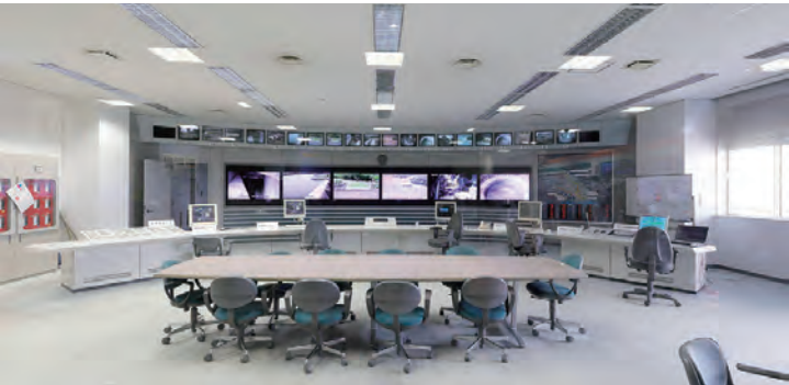
对流入设施、排水泵设备、排水暗渠进行操作以及集中监控设施整体情况的中央操作室
