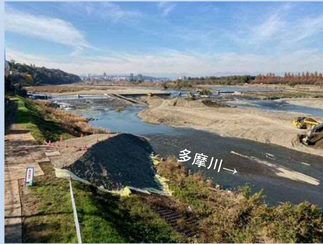
施工箇所に水が入らないようにするため、盛土をしています。(令和3年11月)
