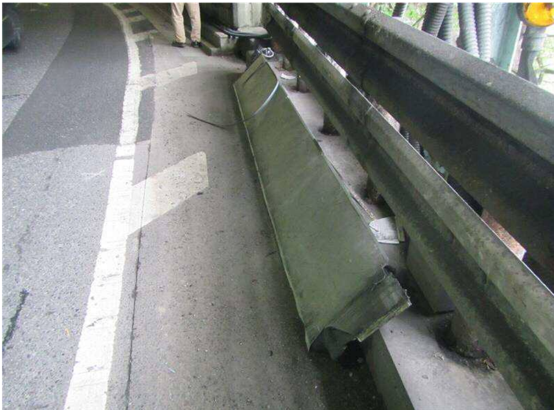
写真③: 接触により落下したパネル
