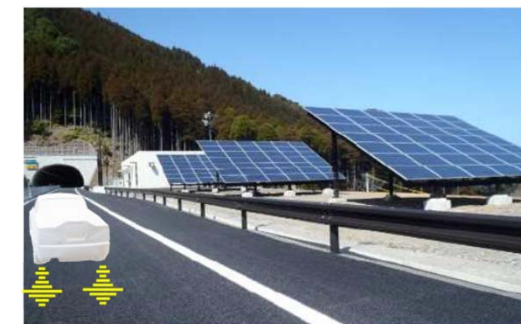
アスファルト面を利用した太陽光、振動発電
