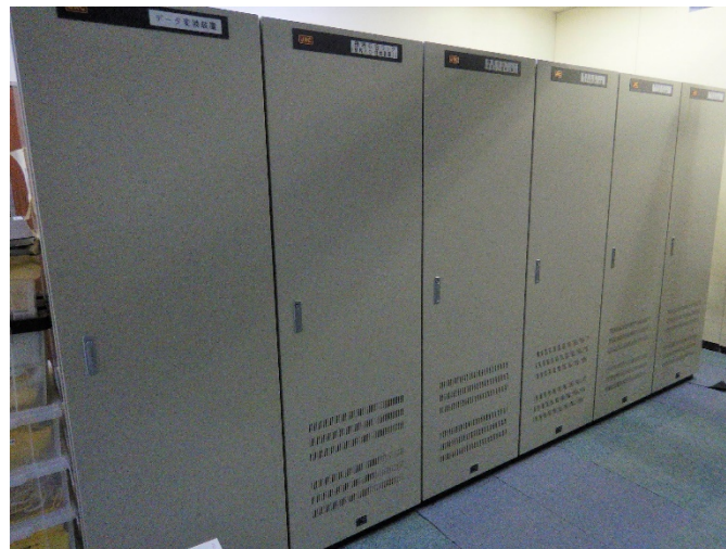
ダム・堰放流制御設備
