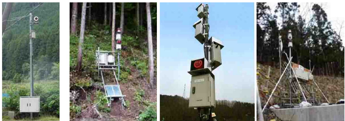
図 34 警報局設置事例
