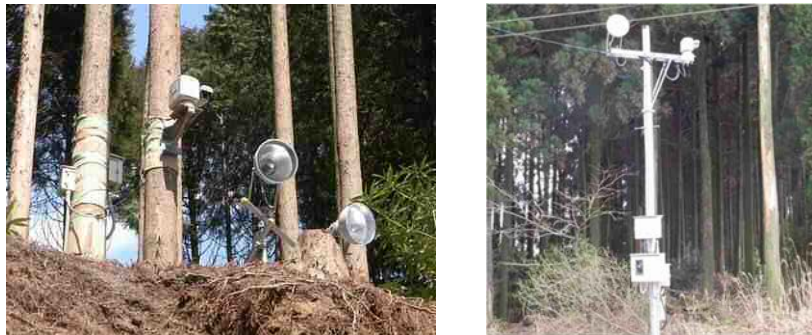
図 31 霧島山の噴火対応で緊急設置した監視カメラ
