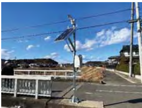
設置されている 簡易型河川監視カメラの例
