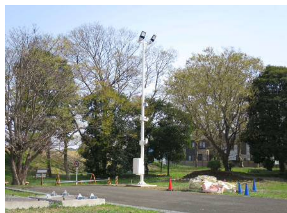
現場施工フィールド L5G・wifi基地局
