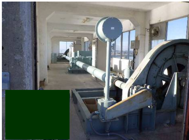
完成(ゲート開閉装置)
