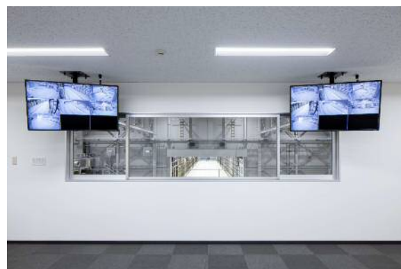
完成(制御兼データ解析室)
