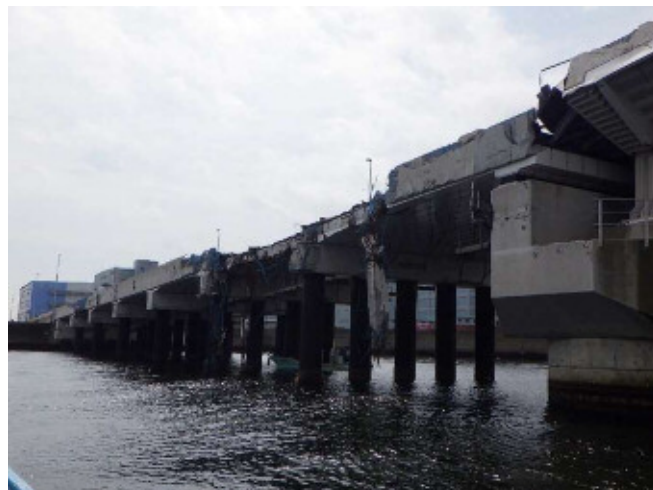
写真-4 PC栈橋部の被災状況
