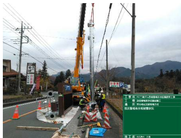
放流警報表示板設置状況
