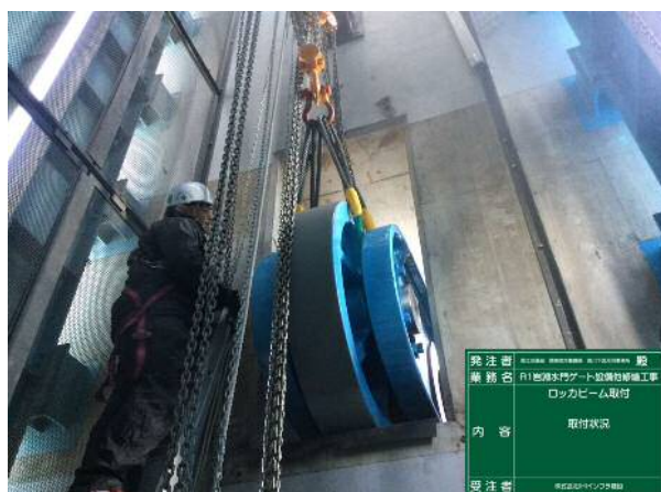
ロックビーム取付状況
