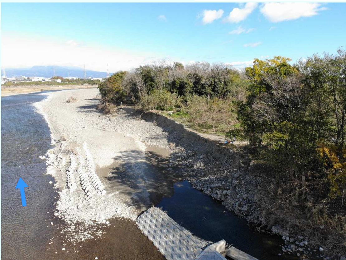
【写真：鐺川右岸（0.2k付近）森新田地先の被災状況】
