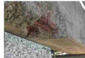
損傷状況(鉄筋露出)
