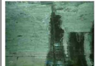
損傷状況(うき・漏水)
