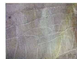
下部工のひび割れ
