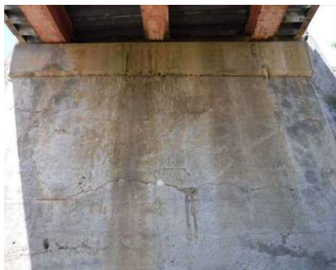
A1橋台堅壁のひびわれの状態
