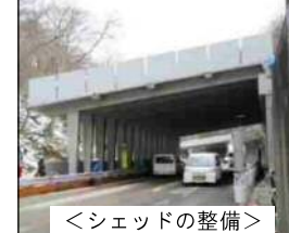
【落石・雪崩対策】
