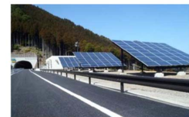
道路を活用した太陽光発電
