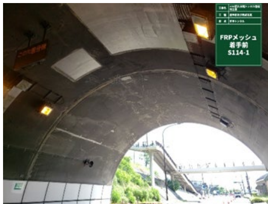
【覆工のひびわれ、うき・はく離】
