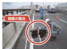
鮫洲埋立部損傷状況
