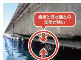
東品川栈橋損傷状況①
