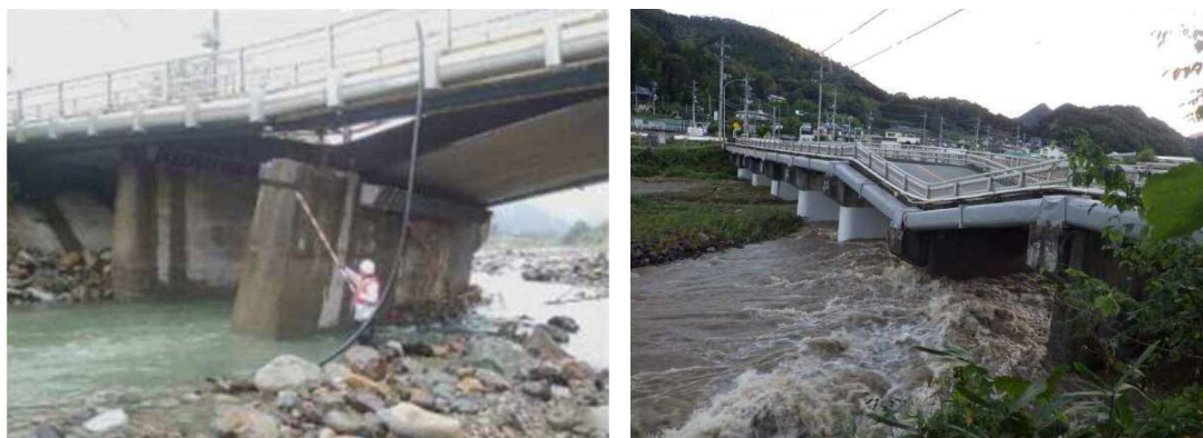
図 国道20号 法雲寺橋の被害状況（令和元年台風19号、1ヶ月半の通行止め）
