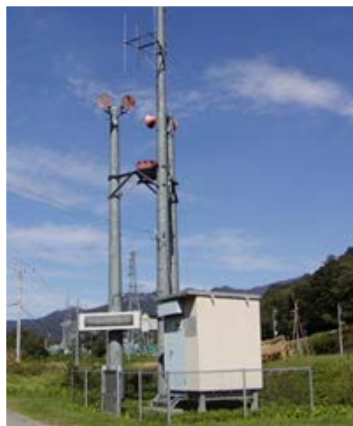
放流警報装置 サイレン局
