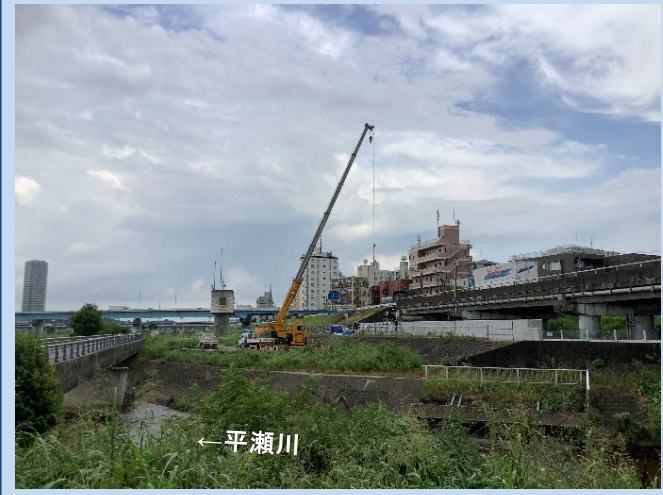
浸水防止施設を設置しています (令和3年7月)
