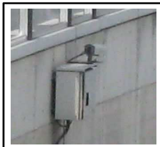
③監視装置 (カメラによる監視)
