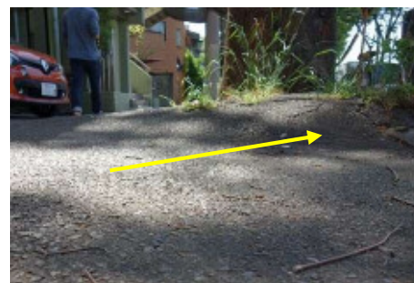
根上による横断方向・縦断方向の急勾配が発生
