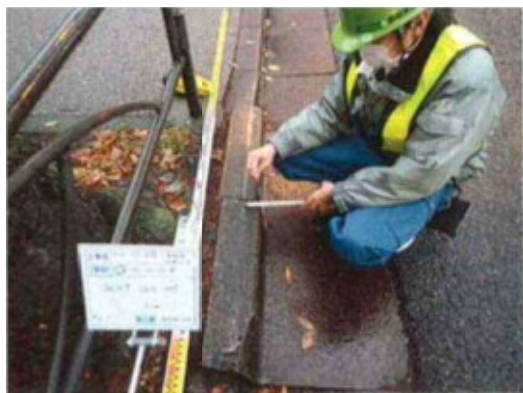
樹木の根による歩車道縁石の押出し
