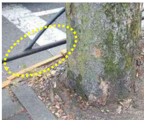
樹木の根による歩車道縁石の押出し
