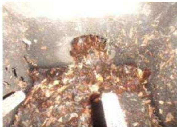
落ち葉が街渠の表面・柵内部に堆積することにより雨水排水が妨げられる
