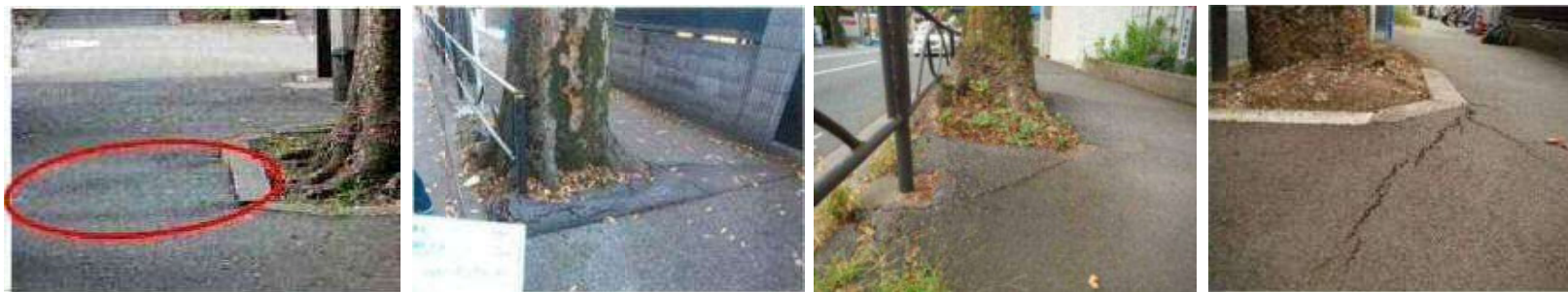
舗装下の根の伸長・根の肥大による舗装の持ち上げ、亀裂の発生
