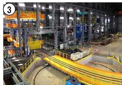
③ 発進立坑地上設備内部 (R1.6時点)
