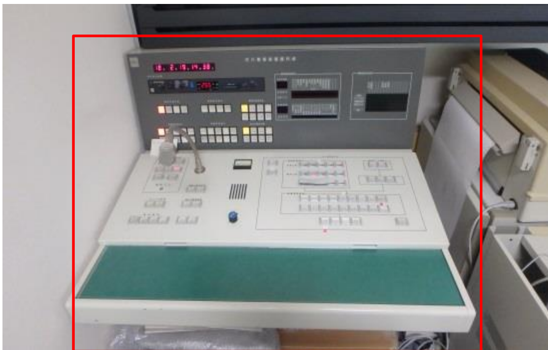
放流警報監視制御設備
