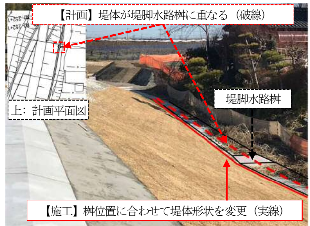
図6 堤体と堤脚水路樹の干渉
