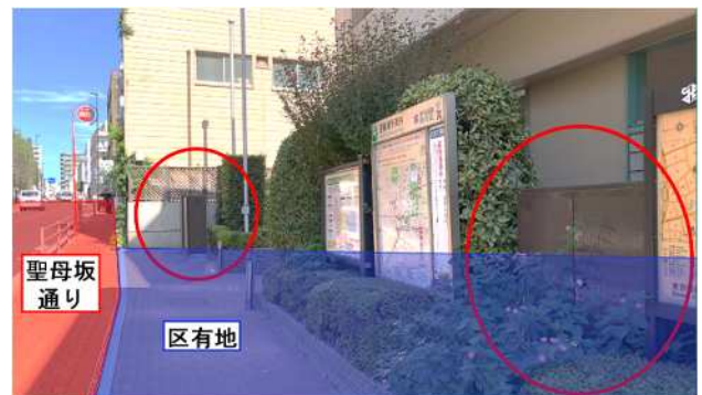
写真-4 区有地内の地上機器設置状況
