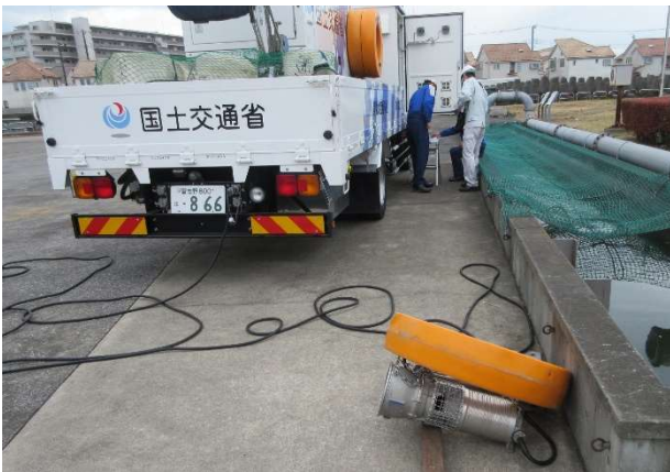
写真-1 排水ポンプ相互接続状況 (K社操作盤とE社排水ポンプ)
