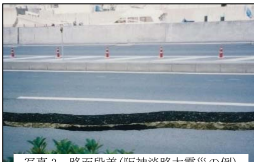
写真3 路面段差(阪神淡路大震災の例)
