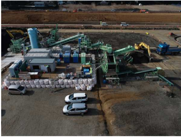
写真-1 プラント全景
