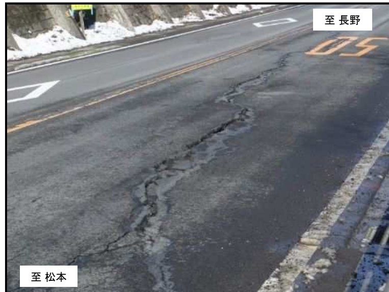
・路面クラック状況 2月19日撮影
