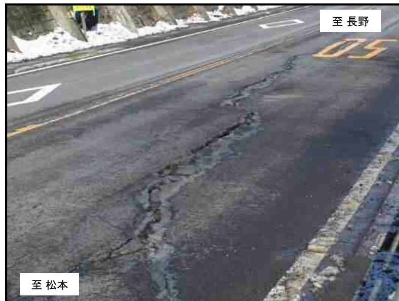
・路面クラック状況 2月19日撮影
