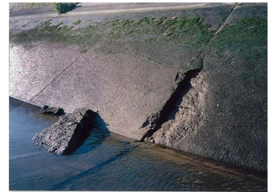
ライニングパネルの損傷状況
