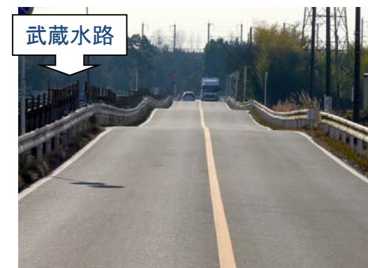
不同沈下の状況
