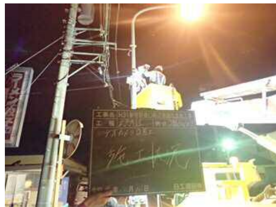
WEBカメラ設置状況【相模原地区】
