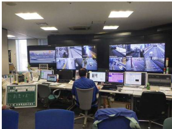
道路情報室仮設運用状況
