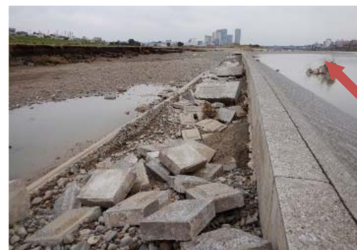
令和元年東日本台風による 洪水時の被災 多摩川左岸低水護岸 洗掘 (世田谷区宇奈根地区)
