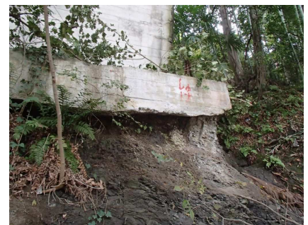
図-7 P4 アーチアバットの付近の浸食
