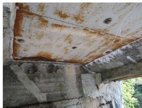
図-2 補強鋼板の腐食と遊離石灰
