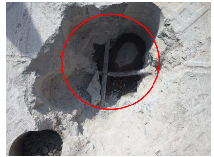
図-4 床版の滞水調査
