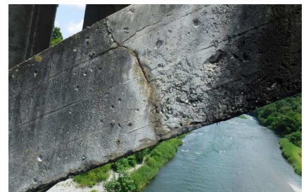
図-6 アーチリブのコールドジョイント
