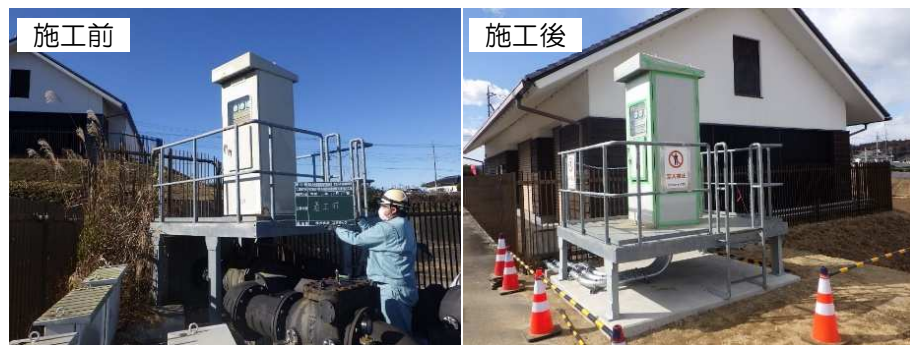
西田川排水機場
