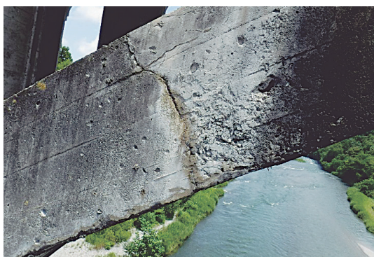
写真-5 アーチリブのコールドジョイント
