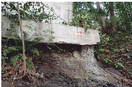
写真-3 アーチアバット周辺の浸食
