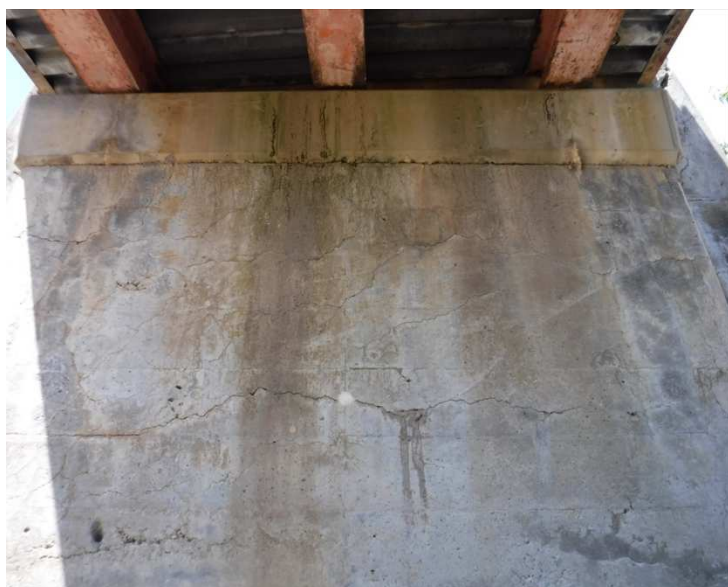
A1橋台堅壁のひびわれの状態
