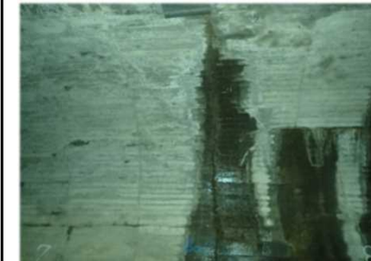
損傷状況(うき・漏水)
