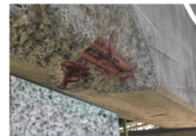
損傷状況(鉄筋露出)
