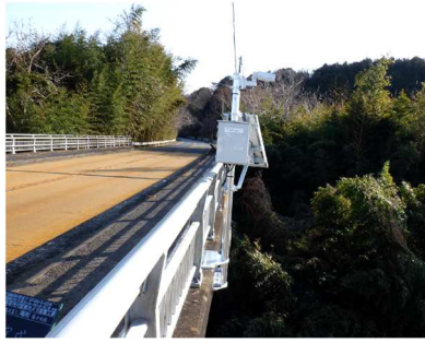
簡易型河川監視カメラ(藤井川)
