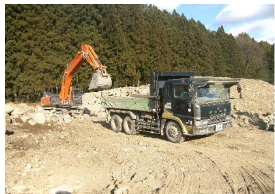
小型無線機による誘導
