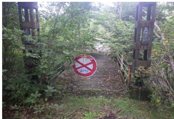
【写真2 鬼押し出し橋の老朽化】
