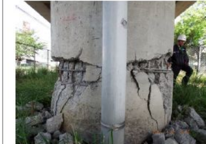
写真-7 段落し部の損傷
