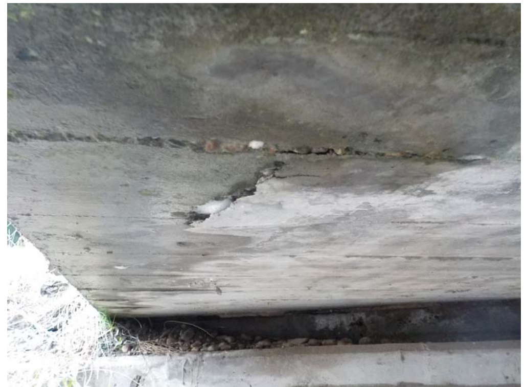
損傷状況(地覆等からの漏水)
