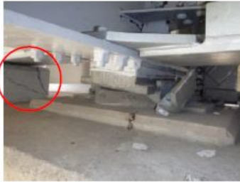
写真-6 支承の破損の状況
