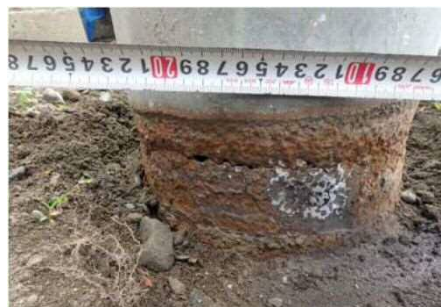
支柱部の損傷状況
