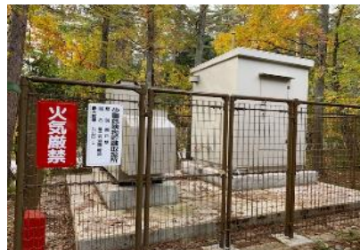
非常電源設備
