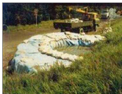
千葉県松戸市漏水状況 (S57)
