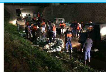
千葉県神崎町漏水状況 (R1)
