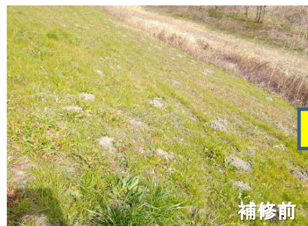
堤防補修例)動物の穴
