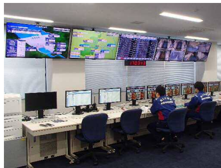
ダムコン (ダム管理用制御処理設備)
