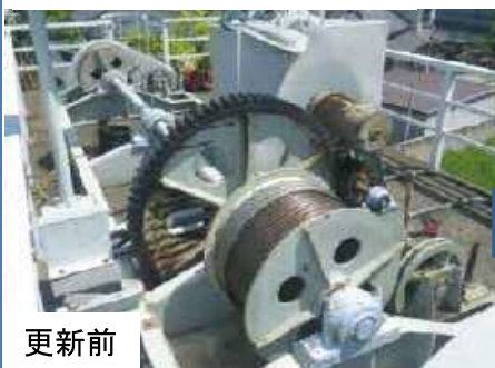
設備の更新例)開閉装置の更新
