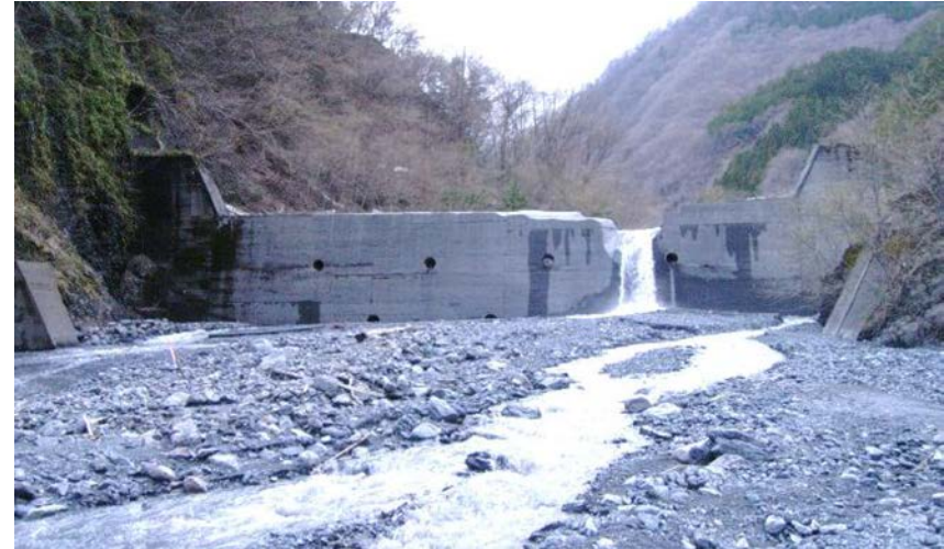
摩耗している堰堤
