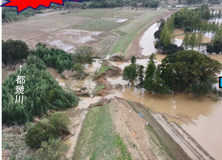
令和元年10月14日 被災状況
