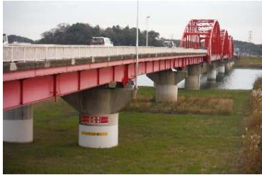
カメラによる水位標の監視
