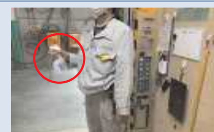
EVの操作盤等の消毒を徹底
