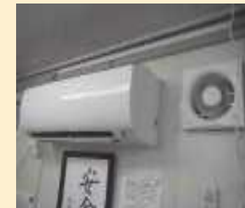
扇風機や換気扇とエアコンを併用
