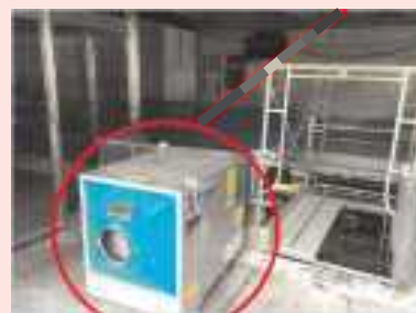
集塵機を設置し室内の換気を実施
