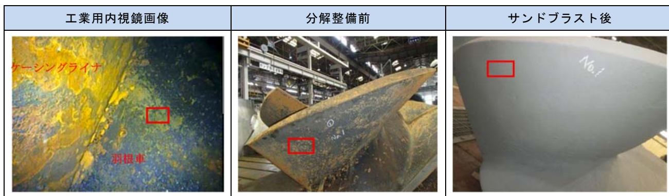
図-10 工業用内視鏡撮影と工場整備時の照合（腐食がなかった事例）
