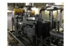
＜自家発電装置＞
