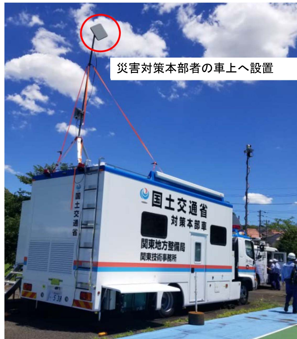
可搬型の無線設備(i-RAS)の整備
