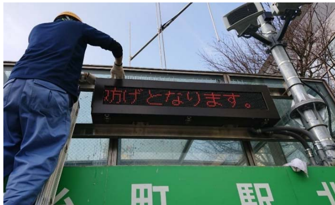
固定系無線システムのデジタル化（墨田区）
