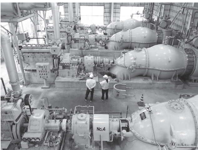
写真二 ポンプ設備（S5排水機場）
