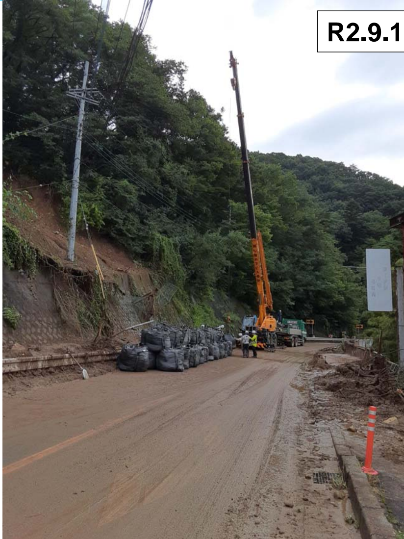
写真①: 土砂流出箇所から高崎市側を望む
