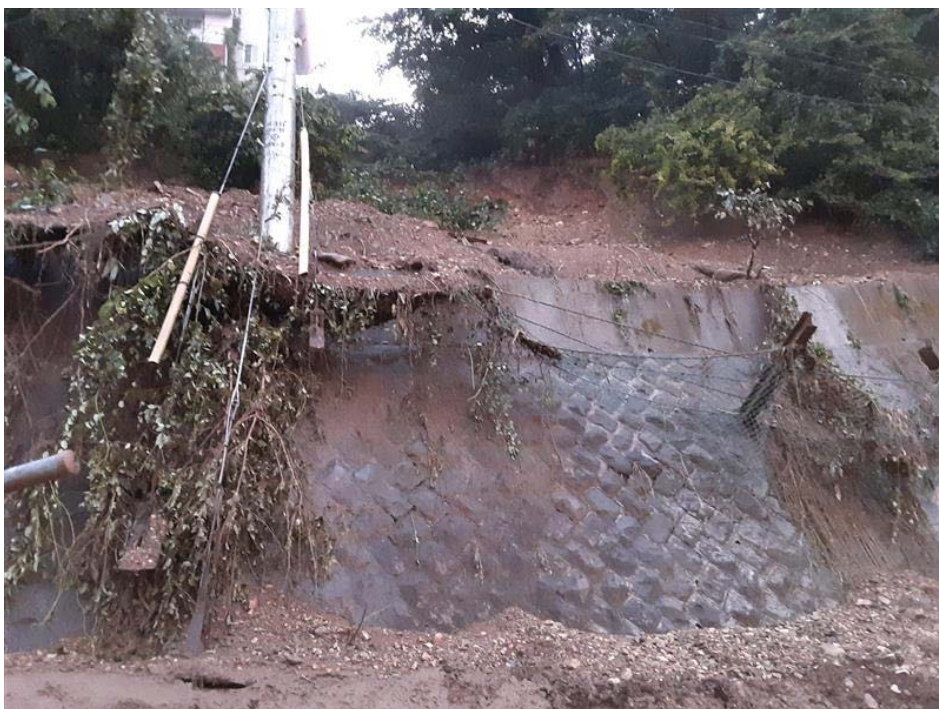
写真②: 土砂流出箇所の法面
